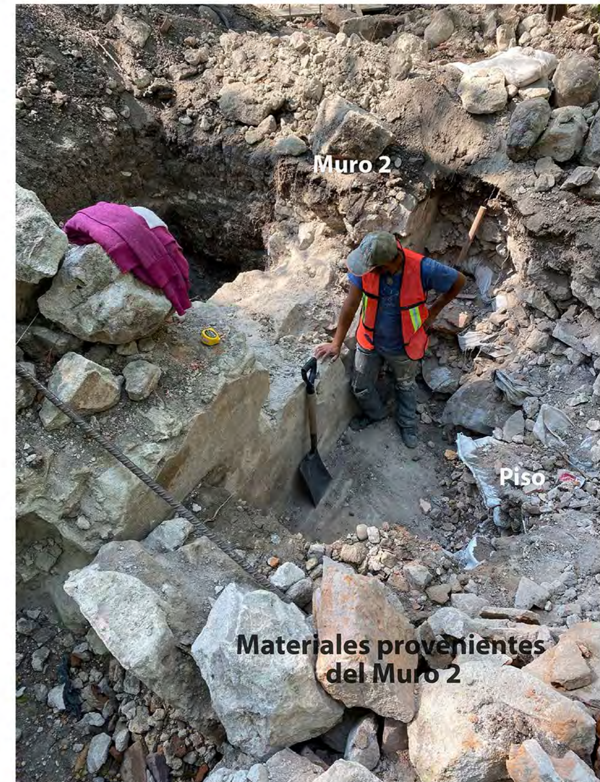
18 de Marzo 2020. Piedras retiradas del muro afectado. El obrero está parado sobre el nivel del piso de la antiguo cuarto bodega. Fachada interior oriente de bodega.
